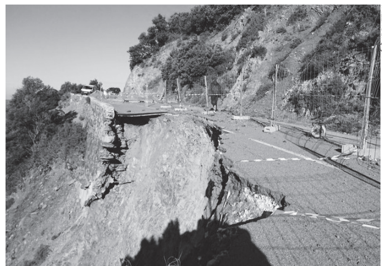
La RD80 à Olmeta di Capi Corsu effondrée après les pluies.
